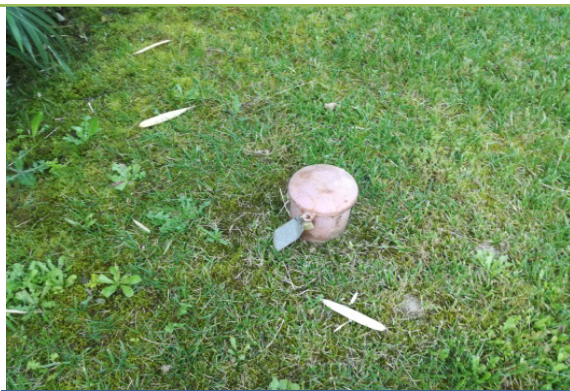
Piezometro per il monitoraggio delle acque sotterranee
