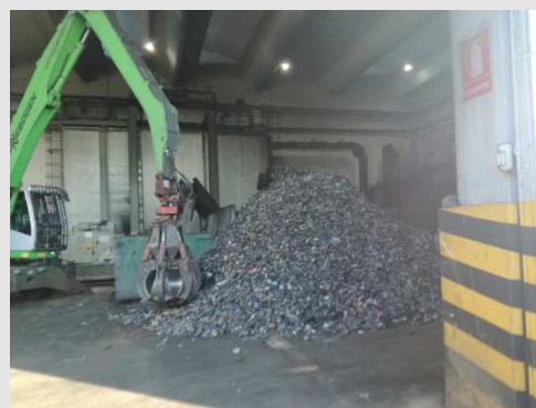
Area F, Trattamento metalli
